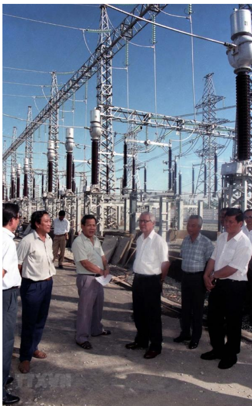
Chiều 20/5/1994, Thủ tướng Võ Văn Kiệt đến thăm trạm biến áp Phú Lâm (Thành phố Hồ Chí Minh), trạm cuối cùng của tuyến đường dây 500 KV Bắc-Nam. (Ảnh: Minh Đạo/TTXVN)
